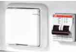
Розетки, автомат УЗО
